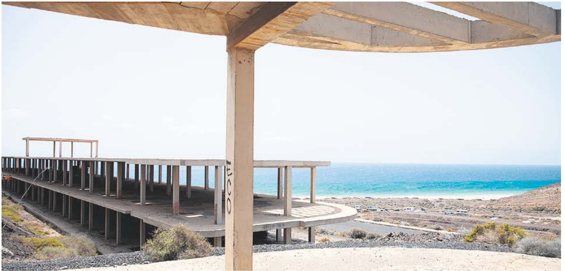
Estructuras de hoteles, paralizadas desde hace 17 años, en la costa del municipio de Pájara. Foto: Carlos de Saá.
