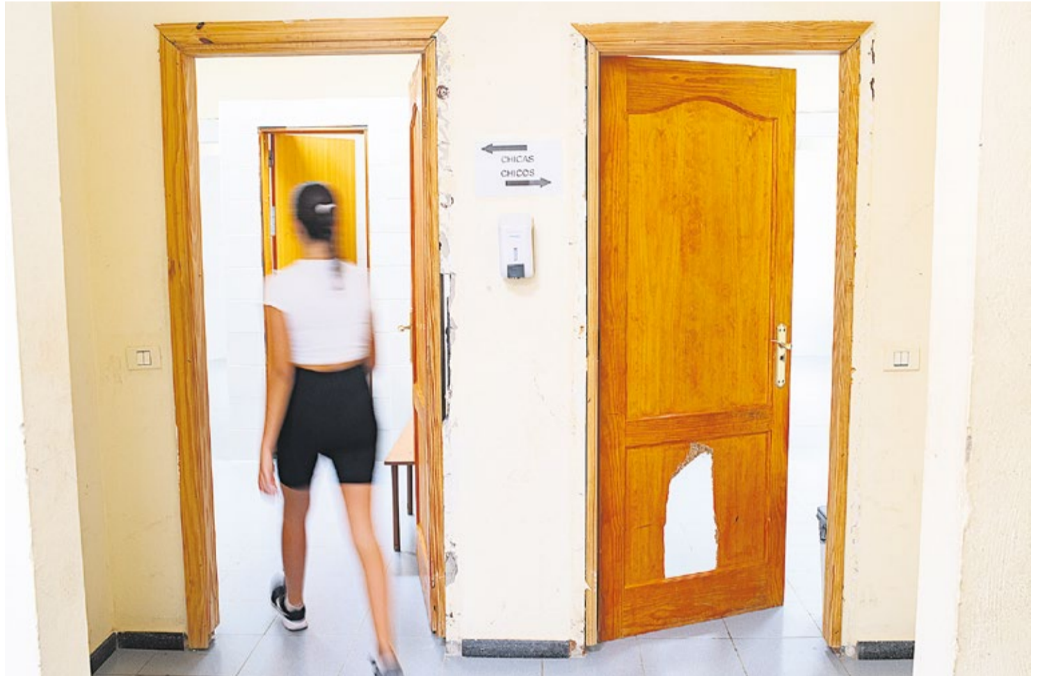
Puertas de acceso a los baños que muestran la precaria situación del centro. Fotos: Carlos de Saá.
