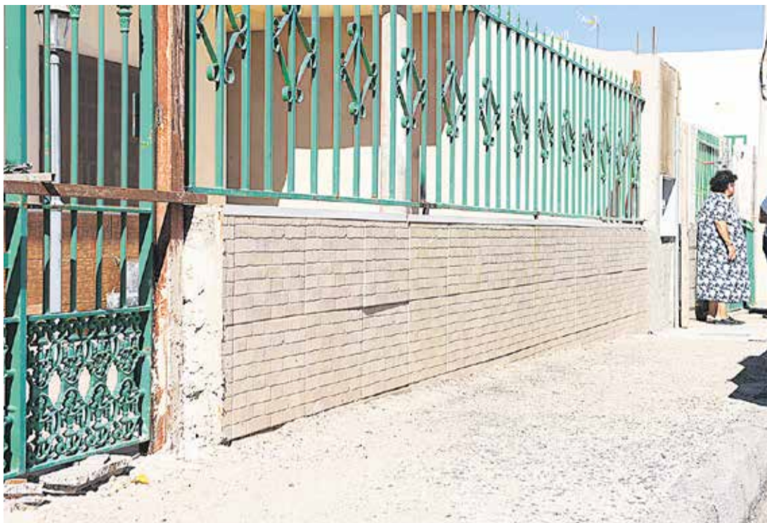
Aceras sin terminar en una calle de El Matorral. Fotos: Carlos de Saá.
