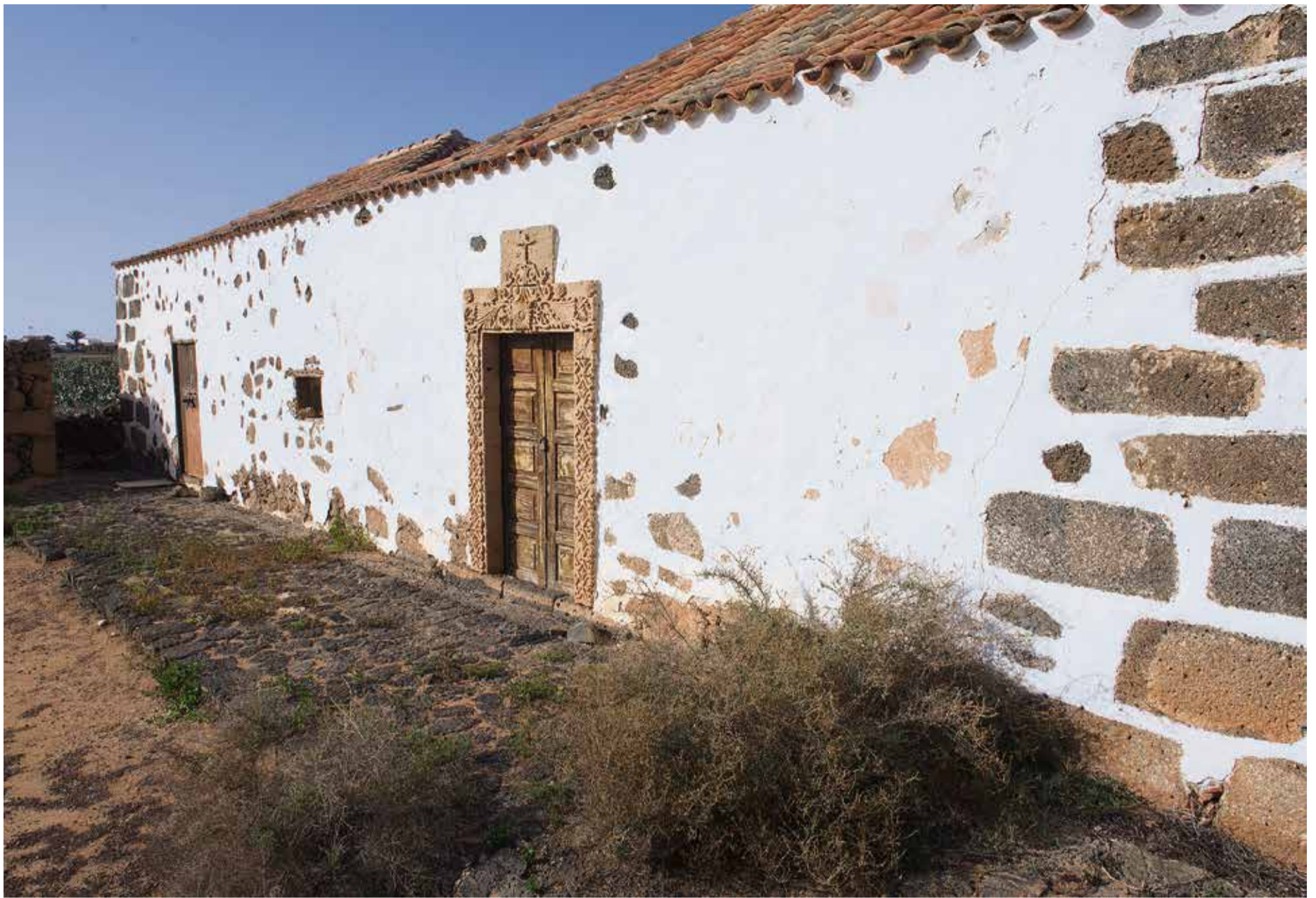
La ermita de La Capellanía se encuentra muy deteriorada. Fotos: Carlos de Saá.
