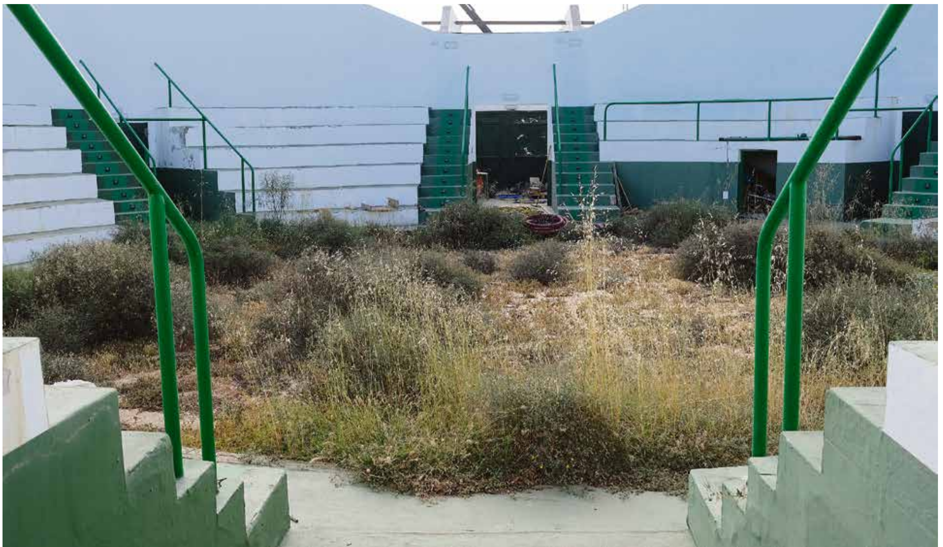
Estado del terrero de lucha de Casillas del Ángel. Fotos: Carlos de Saá.
