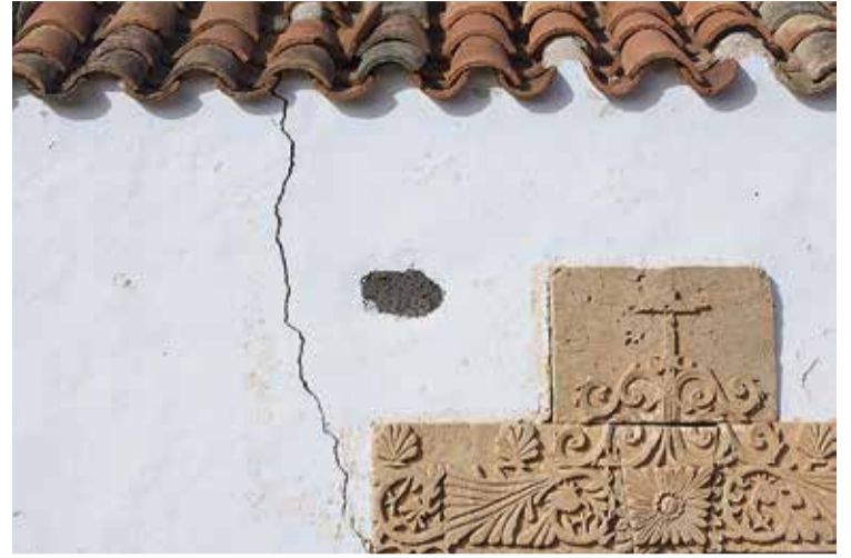
Una grieta amenaza el aislamiento del edificio.
