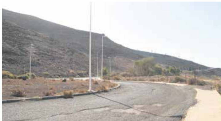
La imagen de la urbanización es desoladora: aceras intransitables, pavimento deteriorado y falta de alumbrado son algunas de las deficiencias.
