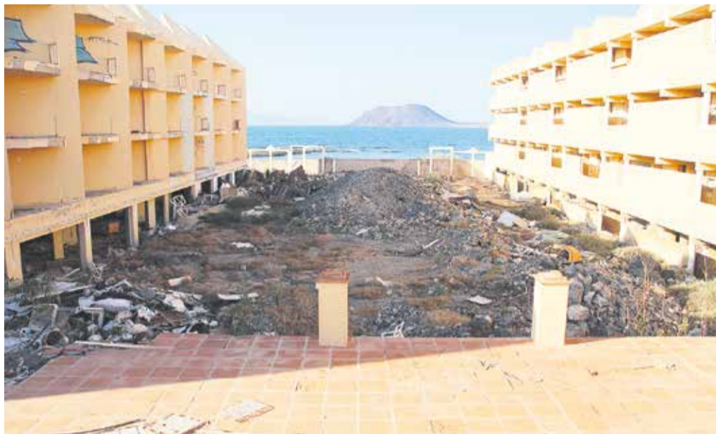
Instalaciones hoteleras en mal estado en Corralejo. Foto: Manolo de la Hoz.
