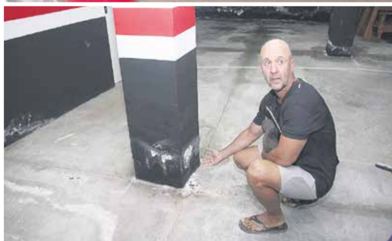
En la imagen principal, garaje inundado en El Palmeral. Sobre estas líneas, edificio en la calle Hierro con daños en los pilares. Fotos: Manolo de la Hoz.
